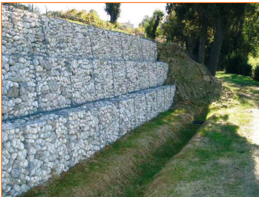
Figura 5. Rete paramassi: intercettano i blocchi di roccia che cadono Figura 5. Gabbionate: si usano per movimenti superficiali in terreni, possiedono una certa deformabilità, e permettono il passaggio dell'acqua, evitandone l'accumulo nel terreno alle spalle dell'opera.
