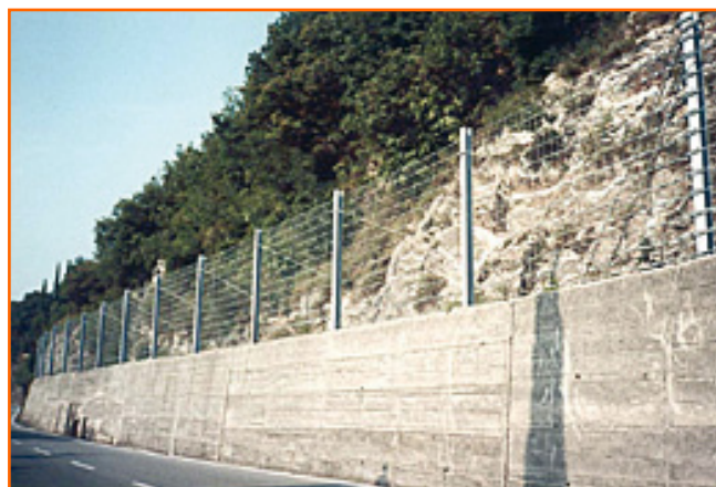
Figura 4. Rete paramassi: intercettano i blocchi di roccia che cadono lungo il pendio.
